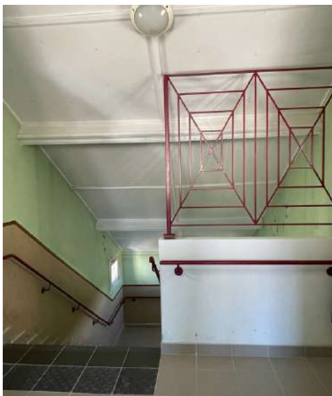
La sécurité est de mise. La main courante en bois sera posée semaine 43
