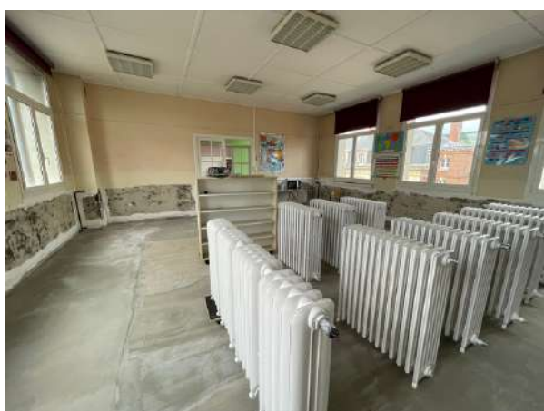
Les radiateurs au garde à vous, en attente d'être repeints !
